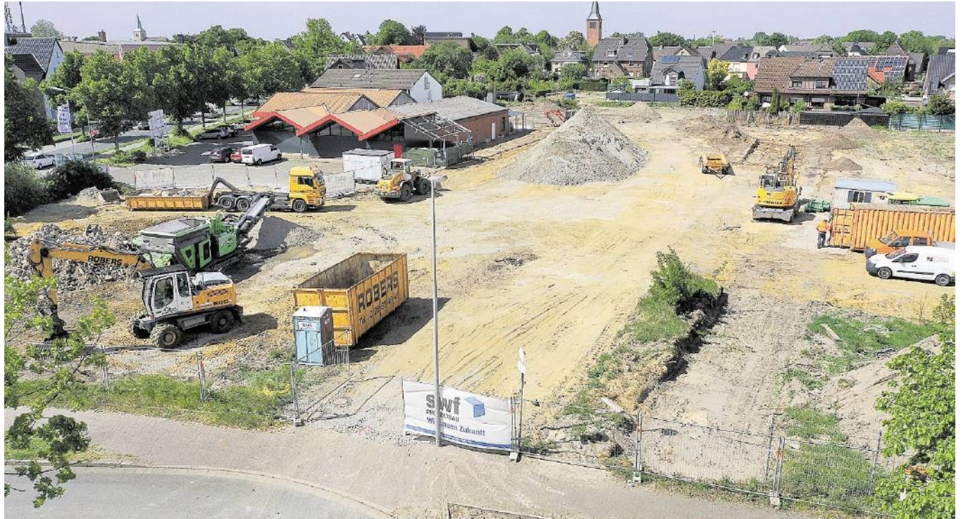
Auf dem ehemaligen Gelände der Firma Rexforth an der Bochumer Straße entsteht ein Neubaugebiet.
